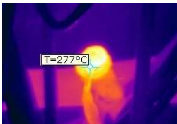
Рисунок 22. Пример обнаружения пожароопасного разогрева болтового контактного соединения
