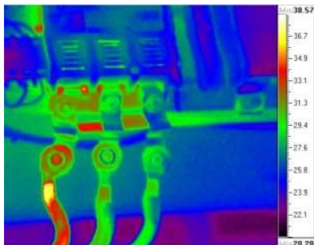
Рисунок 21. Пример термограммы контактных соединений с температурной шкалой
