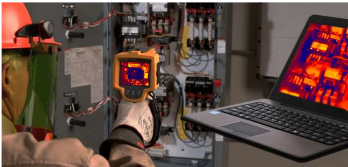
Рисунок 20. Пример проведения тепловизионного контроля электрошкафа
